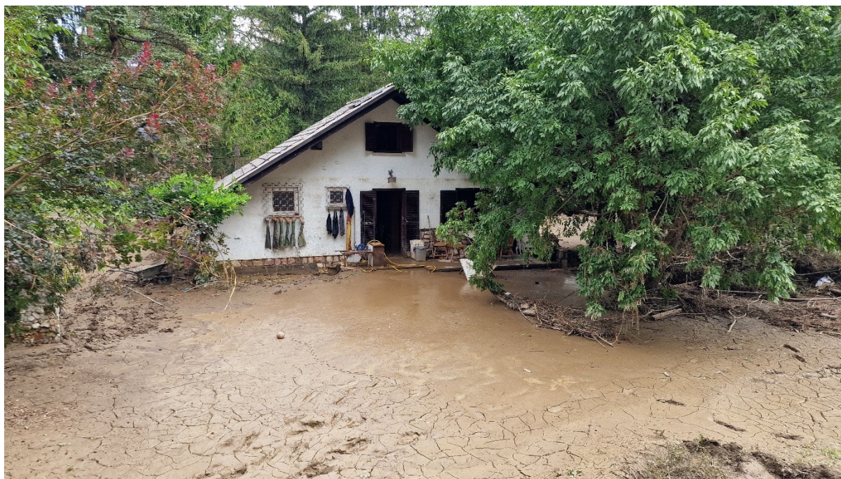
Slika 2: Objekt brez številke, globina vode 2,3 m, odloženo blato >0,3 m
