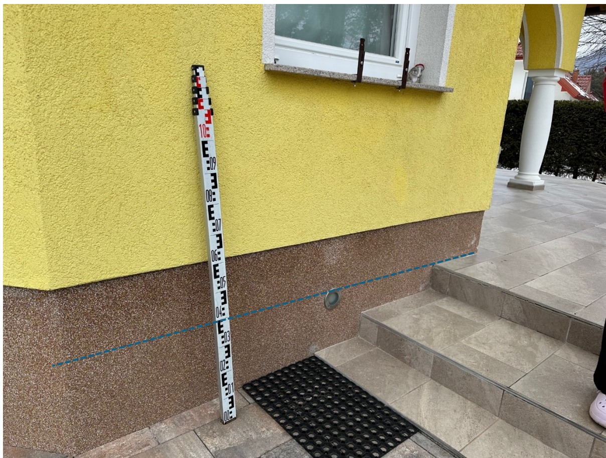
Slika 1: Gladina VV avgust 2023 ~ 0,4 m glede na osnovni teren ob objektu. Objekt se nahaja na nasutem robu ob Savinji. Osnovni(zaledni) teren je ~ 1 m nižji. Objekt se nahaja na gorvodnem robu (glede na tok Savinje) utrditve, ki je bila izvedena po poplavih avgusta 2023.
