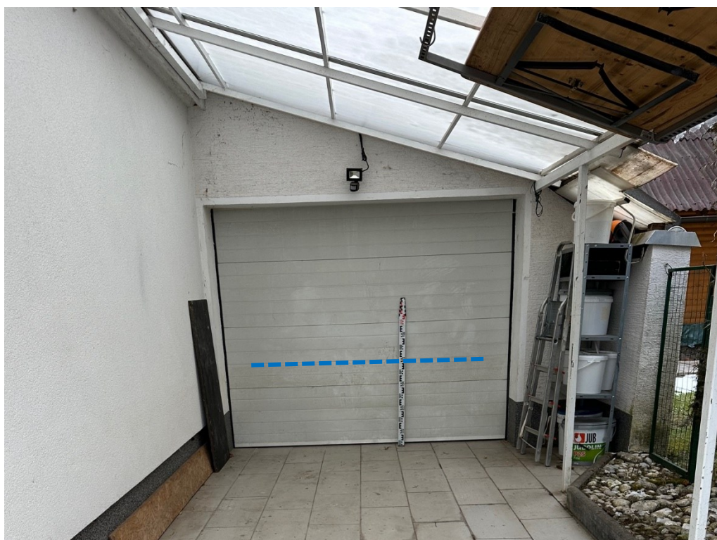
Slika 2: Sledi poplave na garažnih vratih h ~0,68 m.
