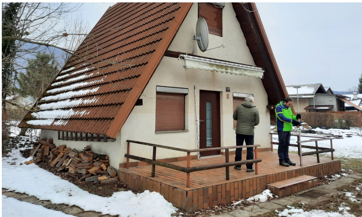
Slika 1: Gladina poplavne vode je segala 1,4 m nad teraso in še dodatno 0,3 m nad okoliškim terenom. Objekt se nahaja v kotanji.
