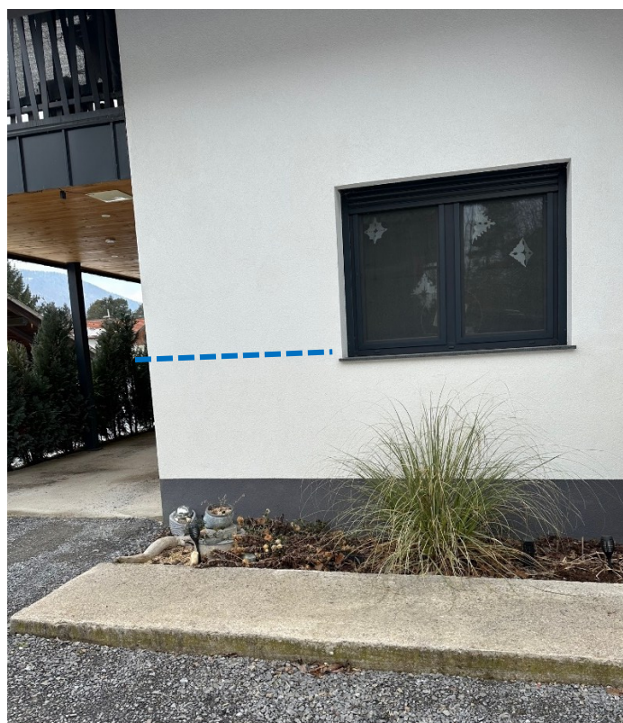
Slika 2: Sledi poplave na vogalu objekta
