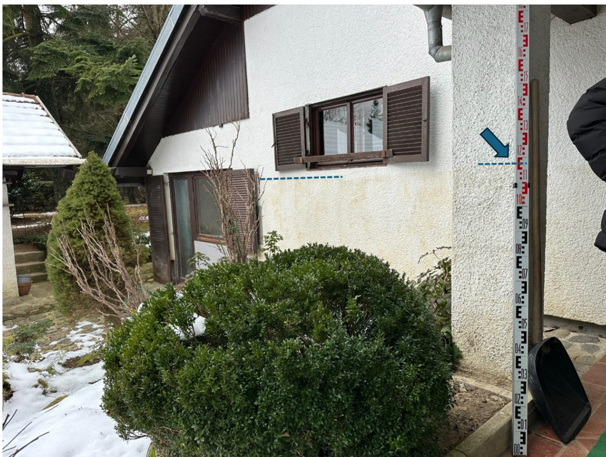
Slika 1: Globina vode med poplavo avgusta 2023 je bila na vhodu 1,18 m, na južnem delu je bila globina vode 1,95 m. Poletaža znotraj objekta (kuhinja) je na višini poplavne vode avgusta 2023.
