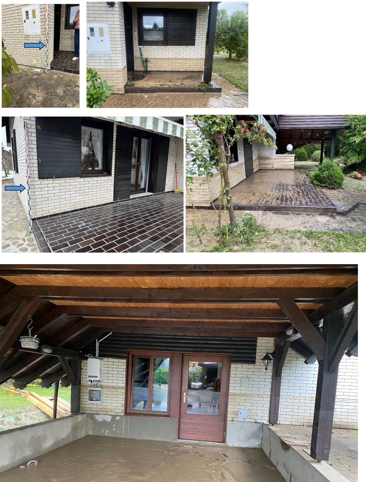
Slike 1-5: Sledi VV avgust 2023 na zaledni in sprednji strani (proti Savinji). Globine vode od 0,75 do 1,0 m sosednjem objektu ( h=1,55 m). Objekt se nahaja na nasutem robu ob Savinji. Osnovni teren je več kot 1 m nižji. Brežine Savinje so slabo utrjene z vidnimi znaki površinske erozije.
