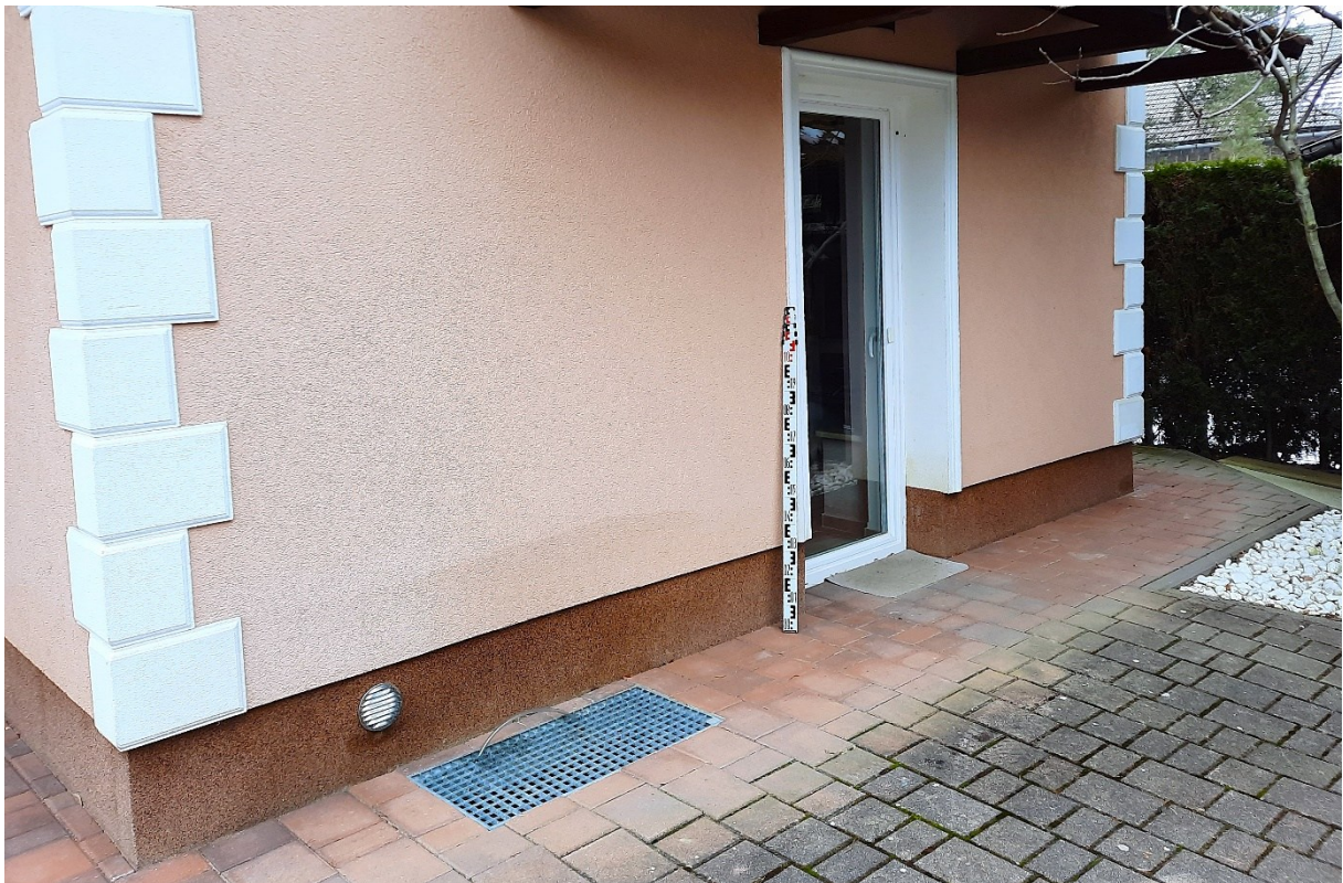
Slika 1: Gladina poplavne vode je segala 0,45 m nad koto pritičja in 0,51 m nad okoliški teren. V kleti je bila centrala kurjava na nafto. Poškodbe stenskih oblog in izolacije ob izlitju nafte.
