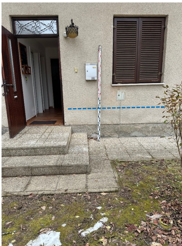
Slika 1: Poplava je segla 0,45 m tlemi v bivalnem delu. Objekt je delno podkleten, centralna kurjava na kurilno olje je v kleti. Globina vod je bila 0,7 m nad osnovnim terenom.
