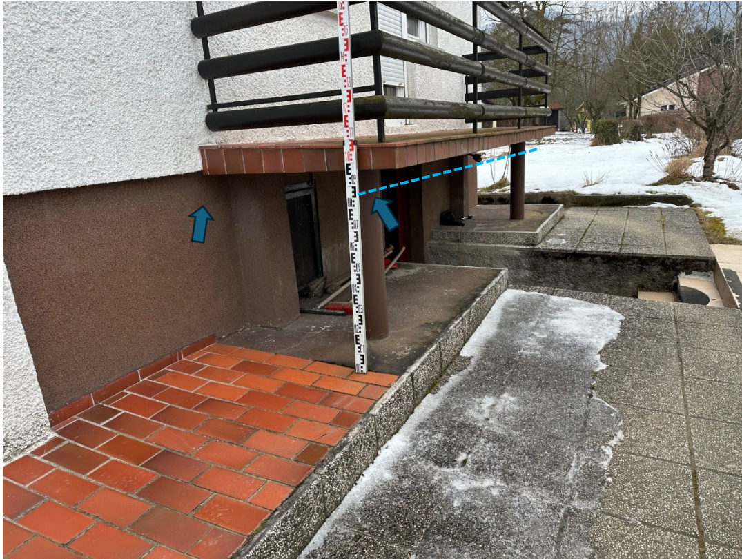
Slika 1: Sledi poplave na stebru in steni so 0,8 m nad povišanim terenom (puščica
