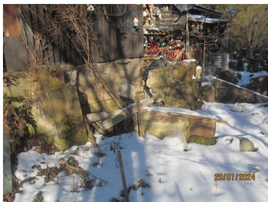
Slika 2: Fotografija objekta – uničena podporna konstrukcija stanovanjskega objekta
