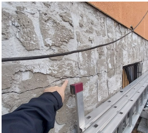
Slika 3: Taborniška pot 18a, horizontalna razpoka na vzhodni fasadi
