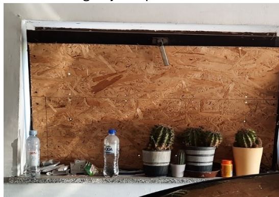
Slika 6: Fotografija nagnjenega okna
