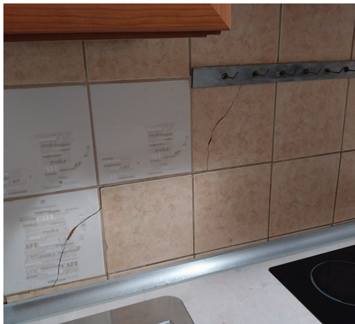
Slika 5: Taborniška pot 18a, diagonalna razpoka na zidu v kuhinji v kletni etaži
