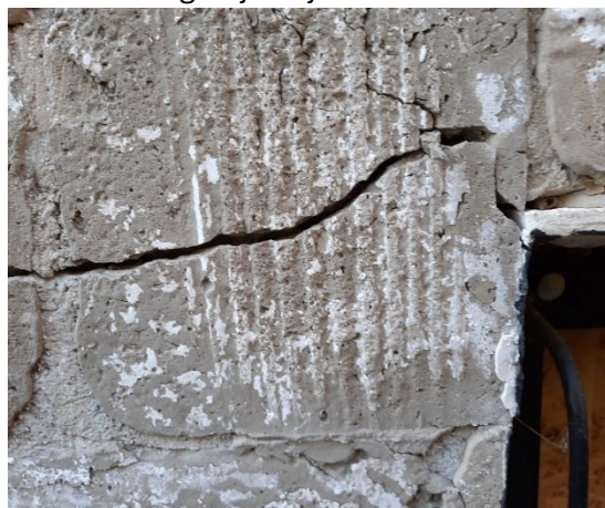
Slika 4: Fotografija razpoke nad oknom
