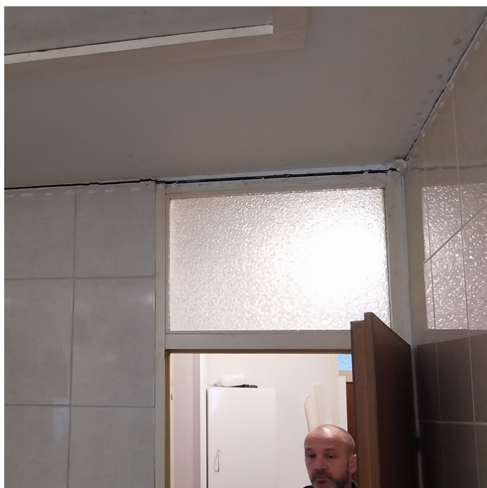
Slika 7: Taborniška pot 18a, razpoka na stiku montažnih elementov v 1.nadstropju
