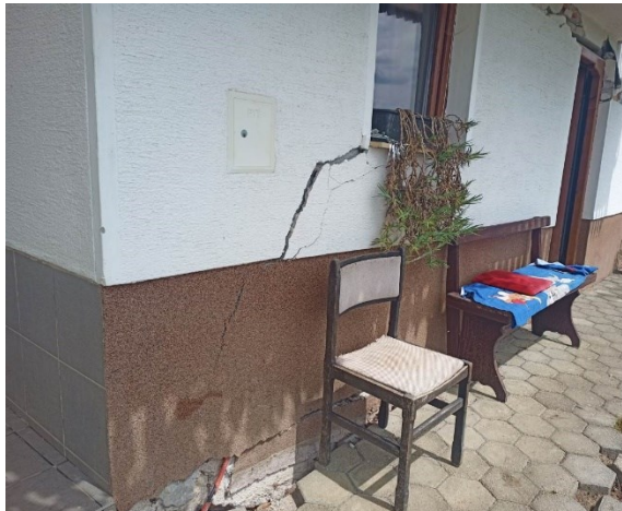
Slika 4: Fotografija poškodb na J fasadi
