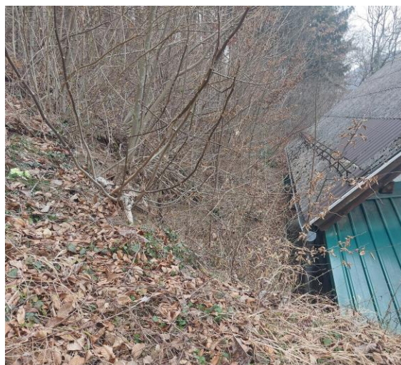
Fotografija 4: Objekt vkopan v močno preperle glinaste skrilavce. Tlaki med nepoškodovanim opornim zidom in stanovanjskim objektom so poškodovani. (27.2.2024).
