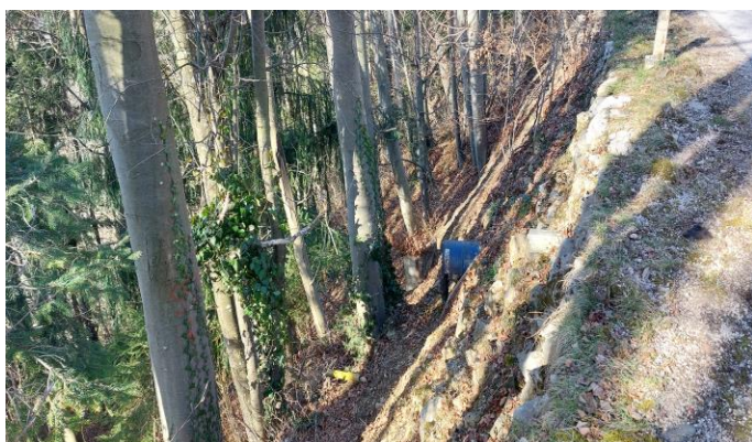
Fotografija 5: Pogled na kamnito zložbo in izcednice pod lokalno občinsko cesto. Cesta se nahaja cca 30 m nad stanovanjskim objektom (5.3.2025).
