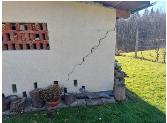
Fotografija 10: Poškodovani vrtni pomožni objekt Vinarje št. 137(4.1.2024).
