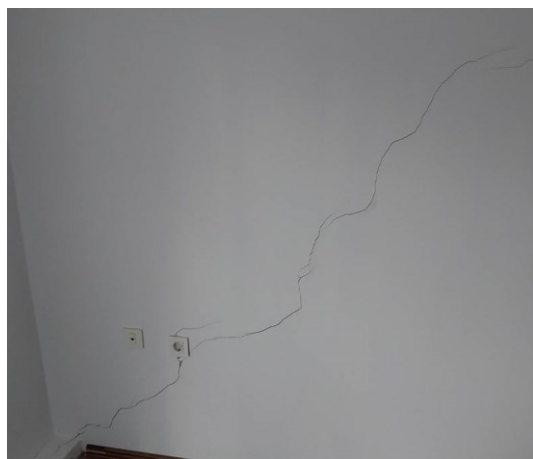
Slika 5: Diagonalna razpoka zidu v mansardi
