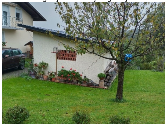
Slika 3: Razpokan pomožni objekt
