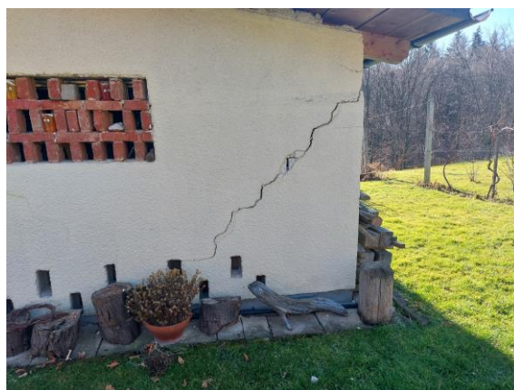
Fotografija 10: Poškodovani vrtni pomožni objekt Vinarje št. 137(4.1.2024).
