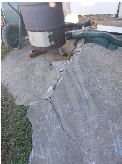
Fotografija 3: Poškodovani tlaki ob objektu Vinarje št. 138 (4.1.2024).
