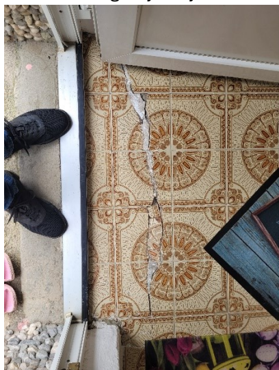
Slika 3: Fotografija poškodb objekta
