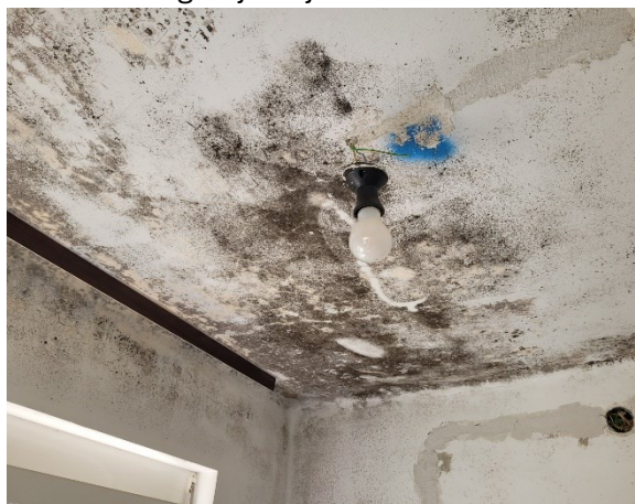
Slika 3: Fotografija poškodb objekta
