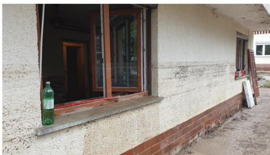
Slika 1: Pogled na fasado z vidno linijo vode in poškodovanim fasadnim pohištvom (slikano po poplavi).
