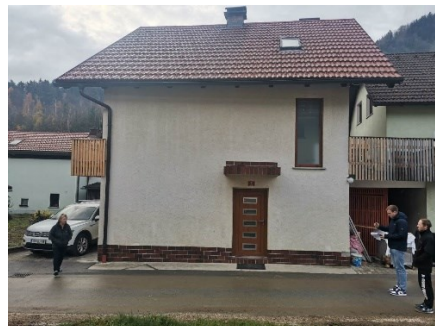
Slika 2: Pogled na severno fasado (sedanje stanje). Vidna linija vode nad vhodnimi vrati.
