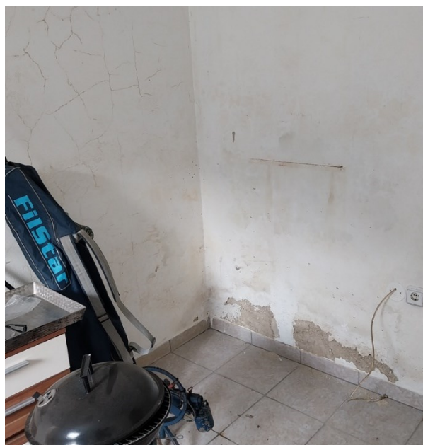
Slika 4: poškodbe ometa in opleska v kletni etaži
