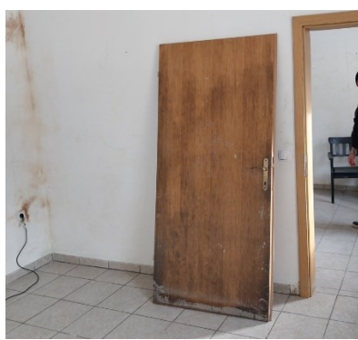
Slika 6: poškodbe ometa in stavbnega pohištva v kletni etaži
