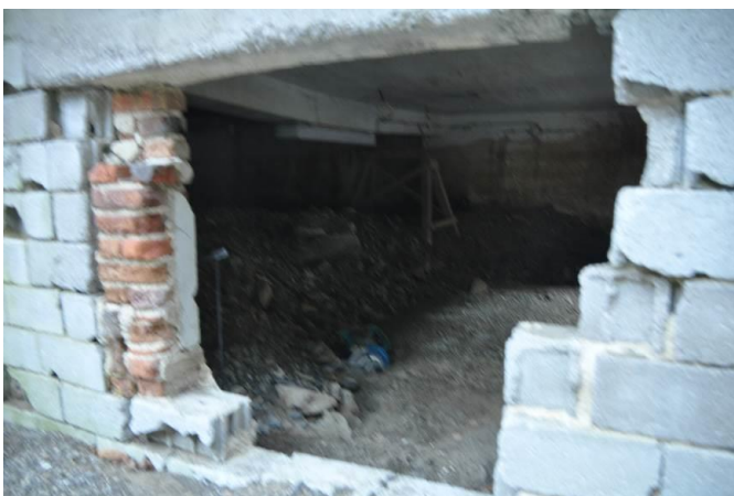
Fotografija 8 – zasut gospodarski objekt – objekt je počil zaradi obremenitve hudourniških voda.
