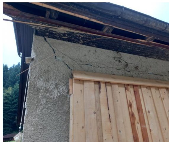
Fotografija 6: Poškodbe na objektu Savina 44 zaradi pritiska zemljine iz usada na objekt.
