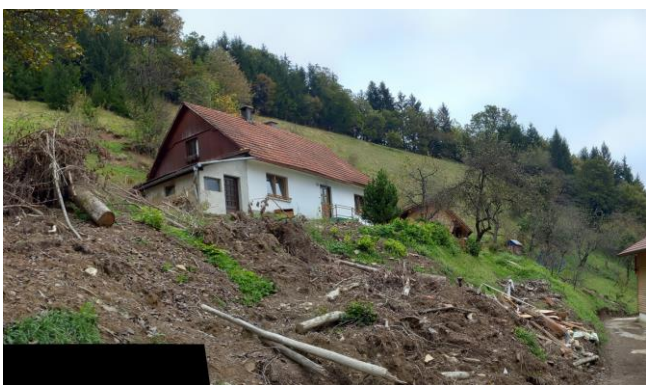
Fotografija 7: Poškodovan objekt Savina 43. Desno porušena drvarnica.
