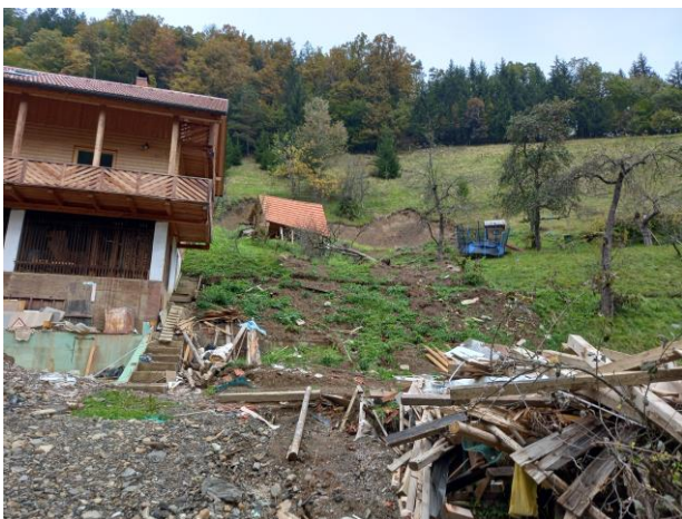
Fotografija 3: poškodovan objekt Savina 44 (dolvodno) zaradi usada nad objektom Savina 43 in erozije vode.
