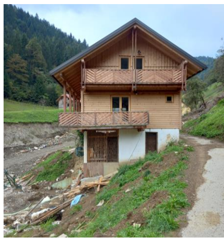
Fotografija 4: Poškodbe objekta Savina 44, porušen nadstrešek.
