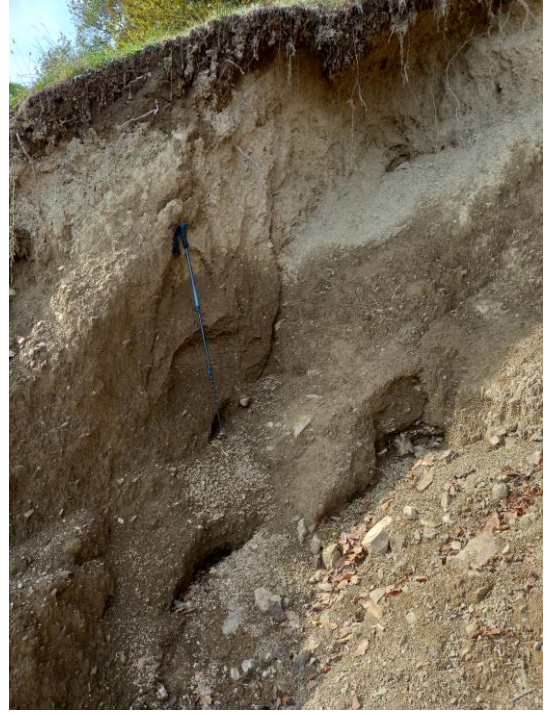
Fotografija 10: Večja debelina grušča na spodnjem delu usada nad objektom Savina 45a. Debelina zaglinjenega grušča do 2,5 m. Znaki dotokov vode.
