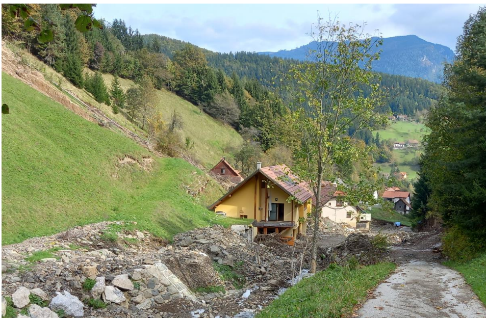
Fotografija 2: Prikaz erozije in hudourniških nanosov Trbiškega grabna. V ospredju poškodovan objekt Savina 45A in usad na pobočju levo.
