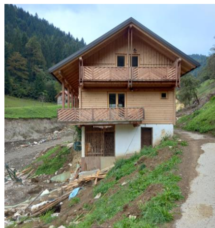
Fotografija 4: Poškodbe objekta Savina 44, porušen nadstrešek.
