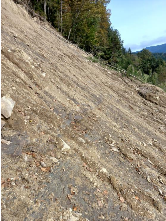
Fotografija 9: Zgornji del večjega usada nad objektom Savina 45a in Savina 45. Izdanja trdna podlaga – glinavec in tufit.
