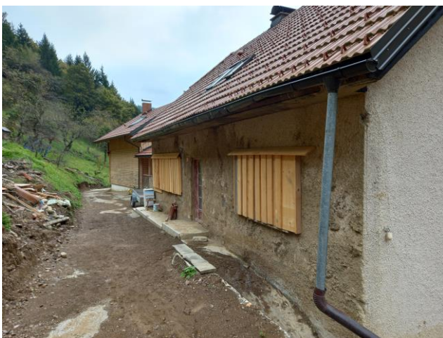
Fotografija 5: Znaki višine zasutja objekta Savina 44 (gorvodno) z zaglinjenim gruščem iz usada na pobočju.
