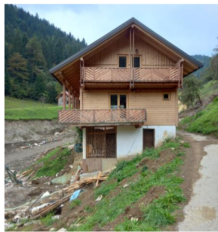
Fotografija 4: Poškodbe objekta Savina 44, porušen nadstrešek.
