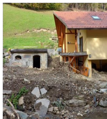
Fotografija 8: Poškodovan objekt Savina 45a zaradi nanosov hudournika.
