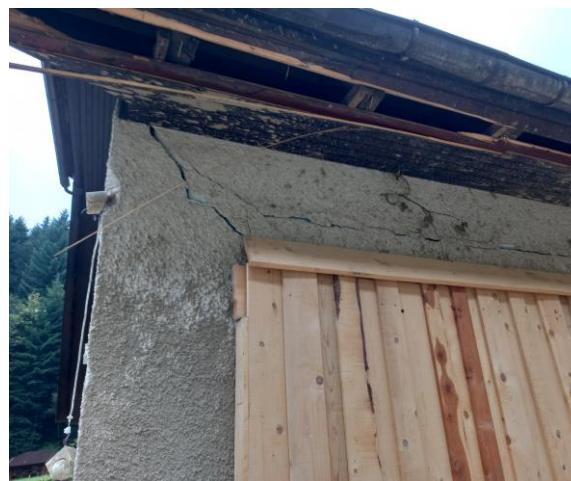
Fotografija 6: Poškodbe na objektu Savina 44 zaradi pritiska zemljine iz usada na objekt.
