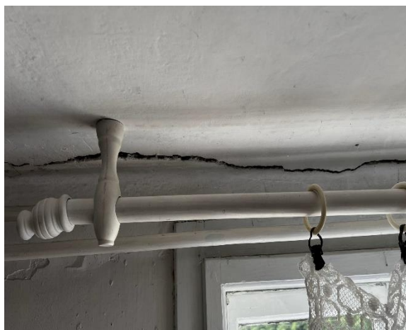
Izrazita razpoka na stropu nad pritličjem
