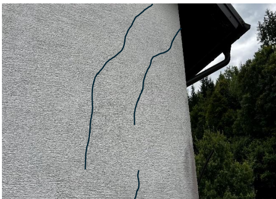
Več poševnih razpok na vogalu (jug)
