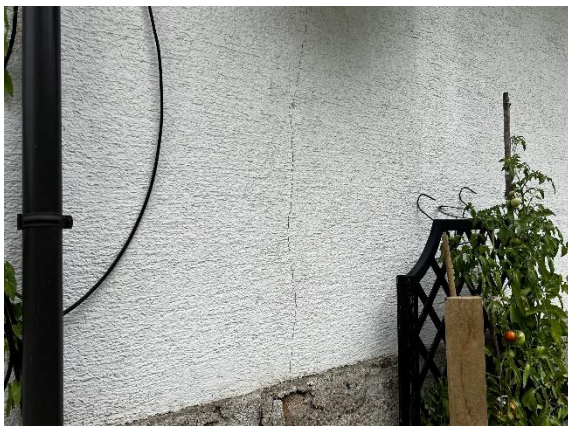
Vertikalna razpoka na JZ fasadi
