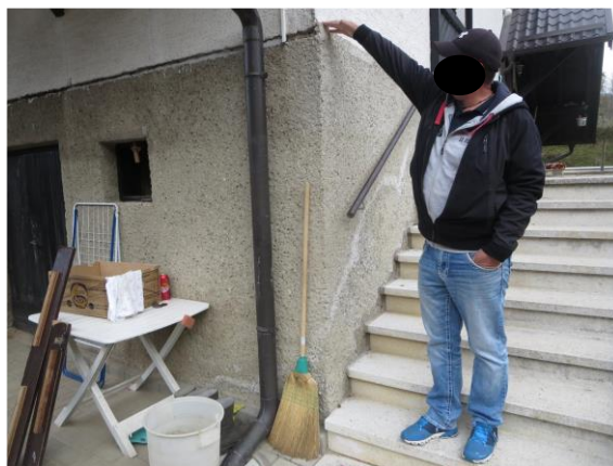
Evidentirana poplavna kota
