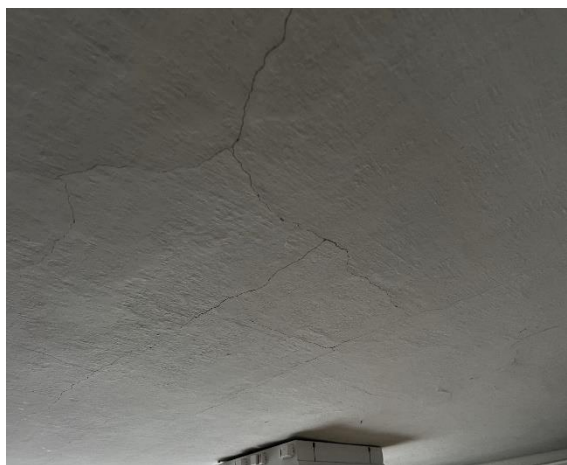
Razpoke na stropu nad pritličjem
