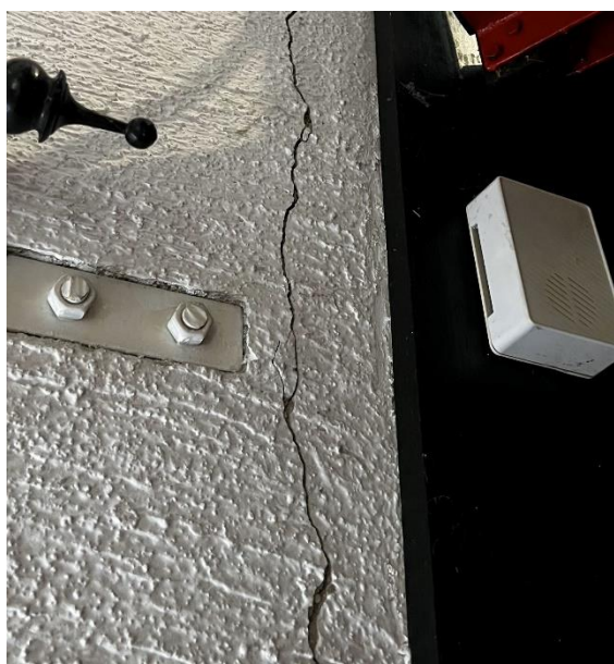
Ista izrazita vertikalna razpoka na notranji strani
