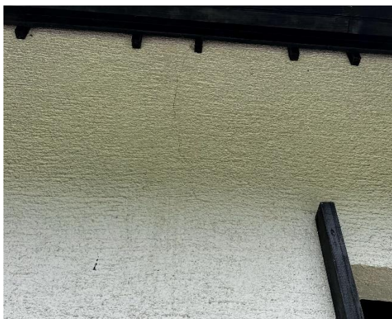
Vertikalna razpoka na steni fasade
