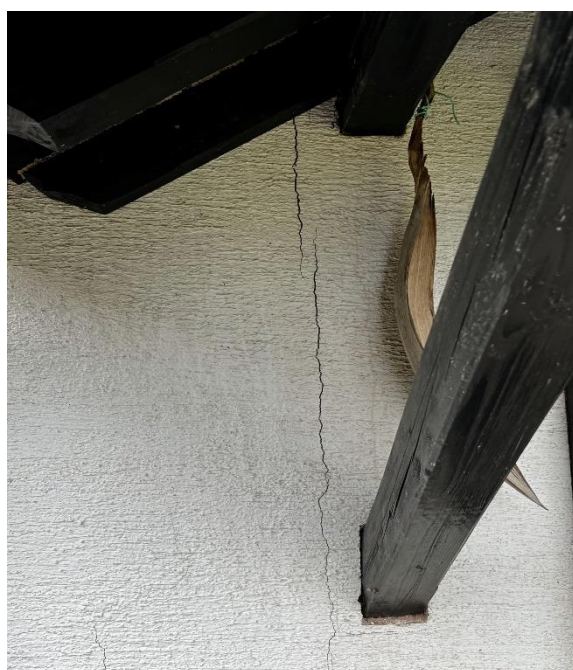
Vertikalna razpoka na steni fasade
