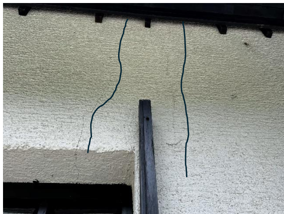
Vertikalni razpoki na JZ fasadi
