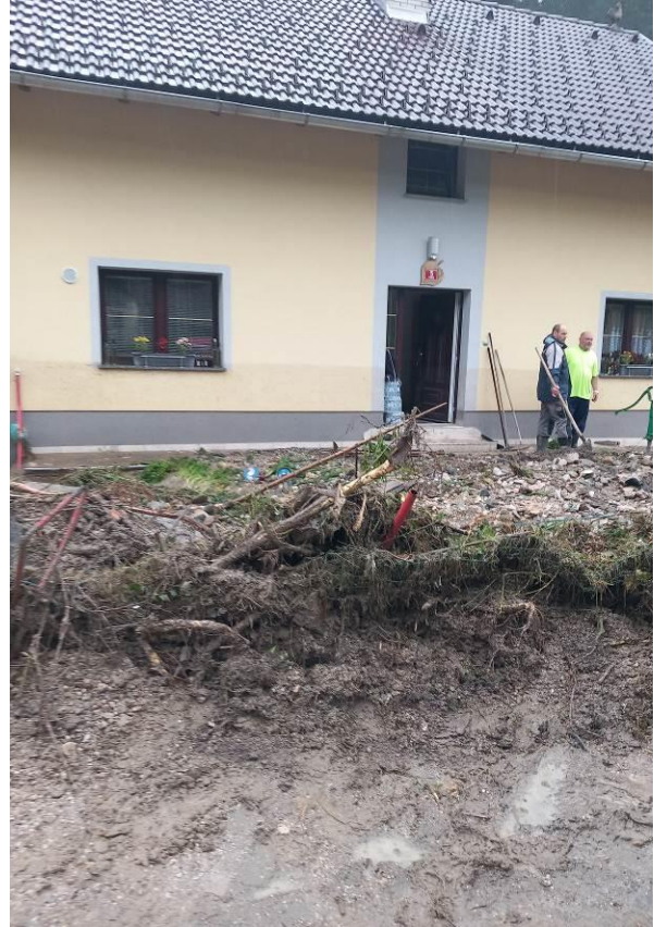
Fotografija 2: J fasada, naplavine in vidni nivo vode
