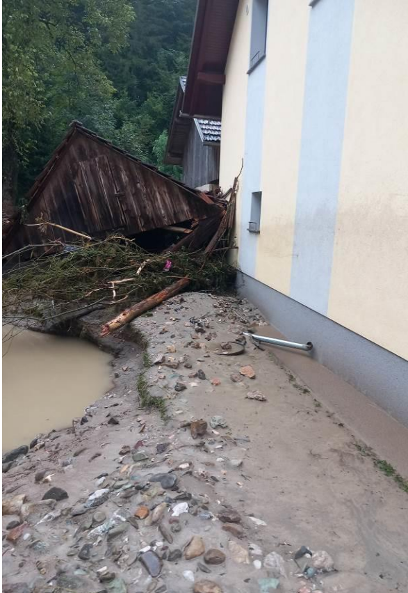
Fotografija 1: Z fasada, naplavine in vidna linija vode
