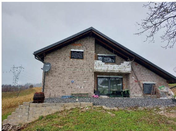
Fotografija 1: Močno razpokana stanovanjska hiša – Veliki Vrh 41 (21.11.2023)
