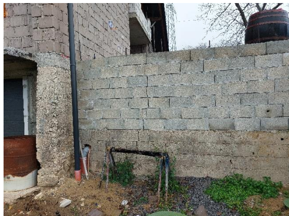
Fotografija 2: Večja razpoka na opornem zidu ob objektu (21.11.2023)
