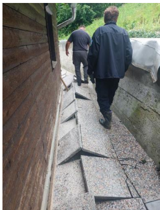
Fotografija 1: Močno razpokana stanovanjska hiša, oporni zid in dvignjeni tlakovci ob objektu (avgust 2023)
