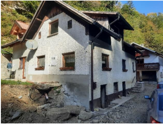
Fotografija 1: Pogled iz J strani na objekt. Vidna je višina vode ter poškodbe na J vogalu
