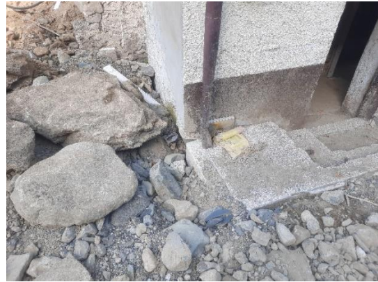
Fotografija 2: Pogled na mesto izpranih temeljev
