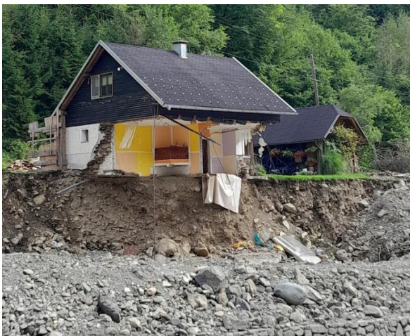
Fotografija 1: Poškodbe objekta Ter 79 zaradi erozije potoka Krumpah.
