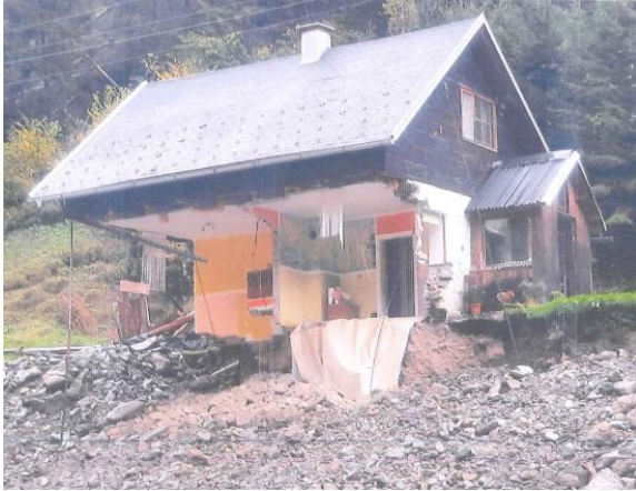
Fotografija 1: pogled na poškodovan objekt iz Z strani
