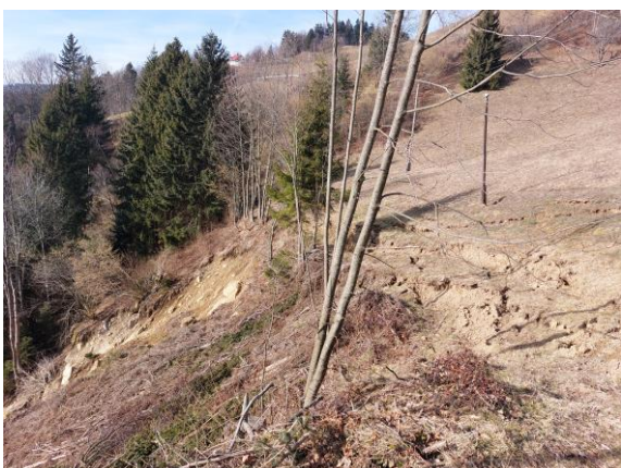
Fotografija 3: Odlomni robovi vidni že cca 1 km nad stanovanjskim objektom Spodnji Razbor 59 (6.2.2024)
