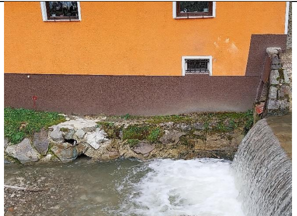
Fotografija 4: Spodjedanje obloge brežine ob vodotoku
