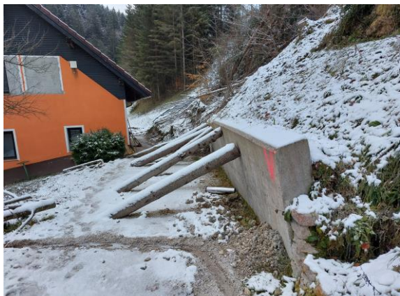
Fotografija 1: Pogled na stanovanjski objekt Spodnji Razbor 4 ter nagnjeno oporno konstrukcijo (6.12.2023).
