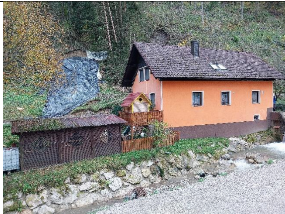
Fotografija 3: Pogled na stanovanjski objekt (sever) in plazovito brežino za objektom
