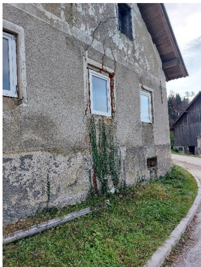
Fotografija 1: Močno razpokana stanovanjska hiša – Onkraj Meže 8 (15.11.2023)
