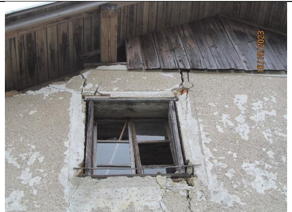
Fotografija 4: Poškodbe na zahodni fasadi
