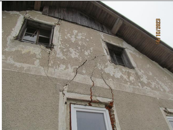
Fotografija 3: Poškodbe na zahodni fasadi
