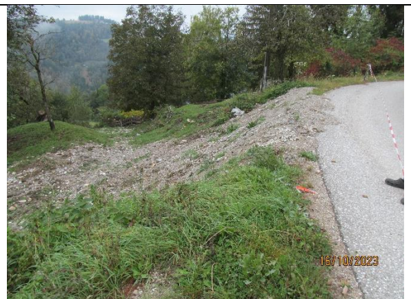
Fotografija 6: Pogled na delno sanirani plaz pod cesto
