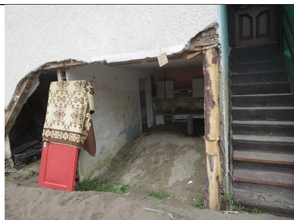
Pogled na porušeno steno: neustrezna lesna konstrukcija in polnilne stene brez ustrezne vertikalne in strižne nosilnosti
