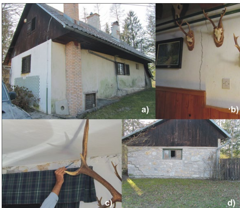
Slika 8: a) Lovska koča v Seču po potresu 13. 3. 2014; b) globoka razpoka v steni; c) razpoka in odpadanje ometa na stiku stropa in stene; d) globoke razpoke na gospodarskem poslopju pri lovski hiši v Seču.
