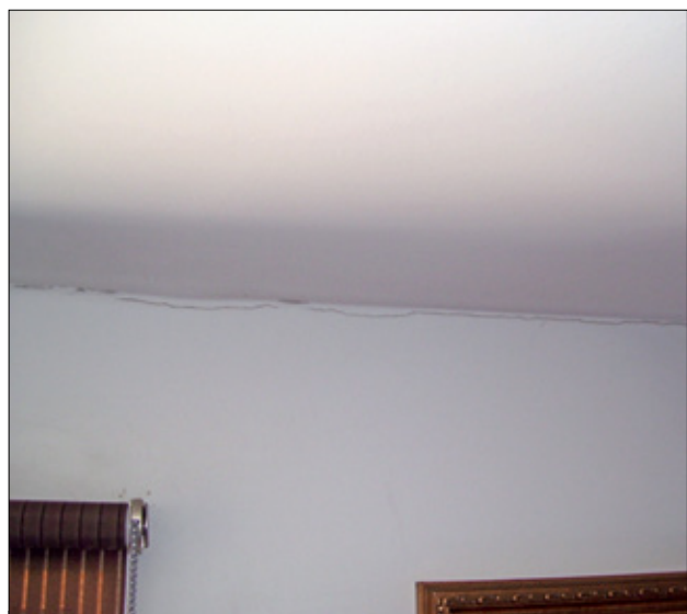
Slika 5: Ob potresu je nastala globoka razpoka na stiku lesenega stropa in nosilnega zidu, stanovanjska hiša na Tajni 5 v Gornjem Gradu.
