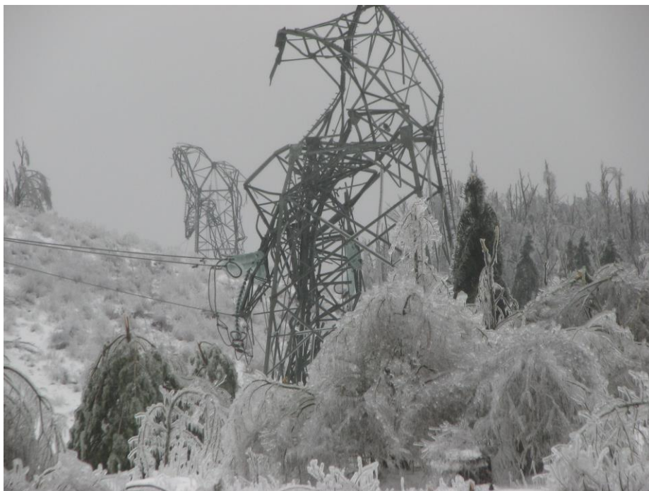
Slika 23: Elektroenergetska infrastruktura je marsikje klonila pod težo ledenega oklepa. Fotografijo je priskrbelo Ministrstvo za infrastrukturo.
