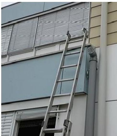
Slika 25: montiran vertikalni vod z zaključkom.
