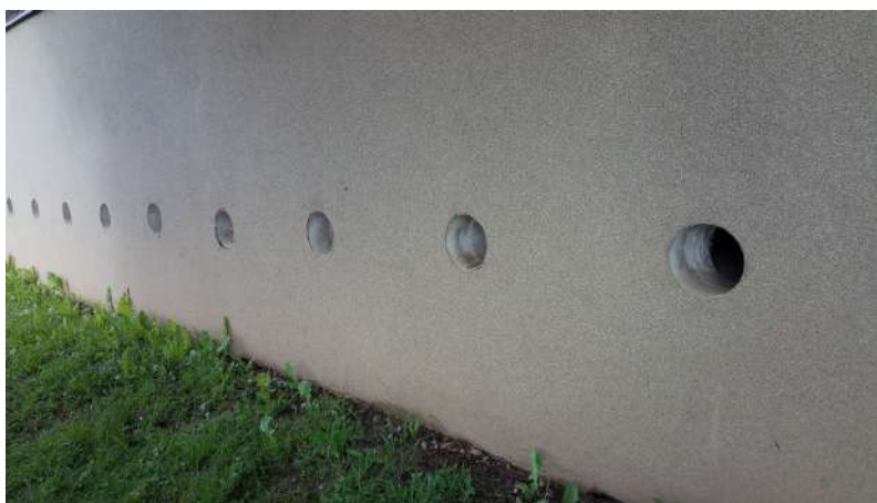
Slika 36. Luknje pod temeljno ploščo v učilnici
