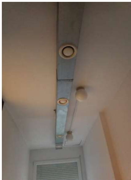
Slika 67. Ventilacija v sanitarijah ob igralnici
