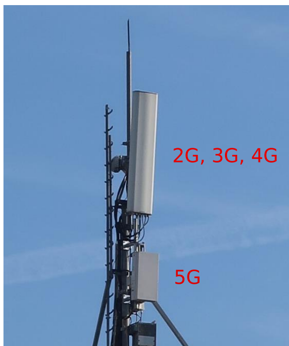
S 5: Prikaz antenskega stolpa na poslovni stavbi, kjer se na isti lokaciji nahajata bazna postaja obstoječega omrežja 2G, 3G in 4G ter nova bazna postaja omrežja 5G.
