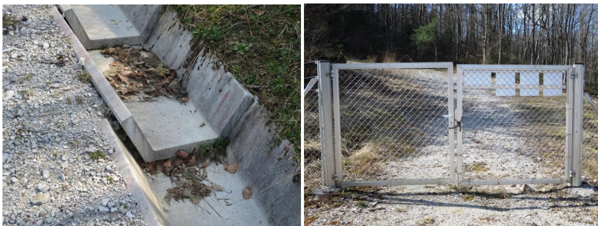
Slika 76: Zgornja cesta na odlagališču Boršt, zamik kanalet (levo), vidni premiki na vhodnih vratih (desno)
