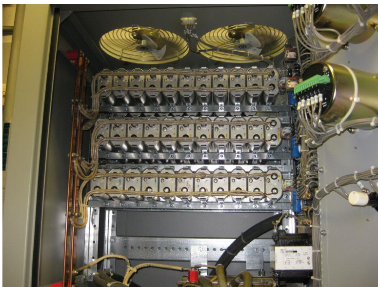
Slika 70: Notranjost 118 V regulacijskega transformatorja (Foto: inšpekcija URSJV)
