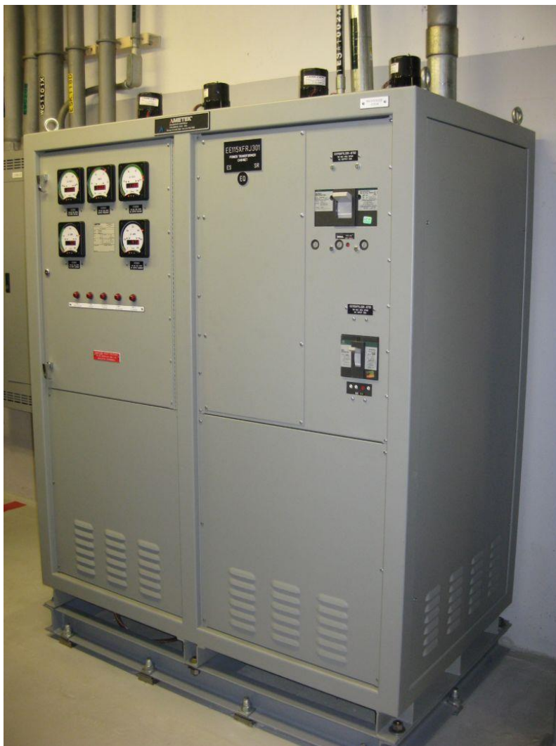
Slika 69: 118 V regulacijski transformator, zamenjan v remontu 2013 (Foto: inšpekcija URSJV)
