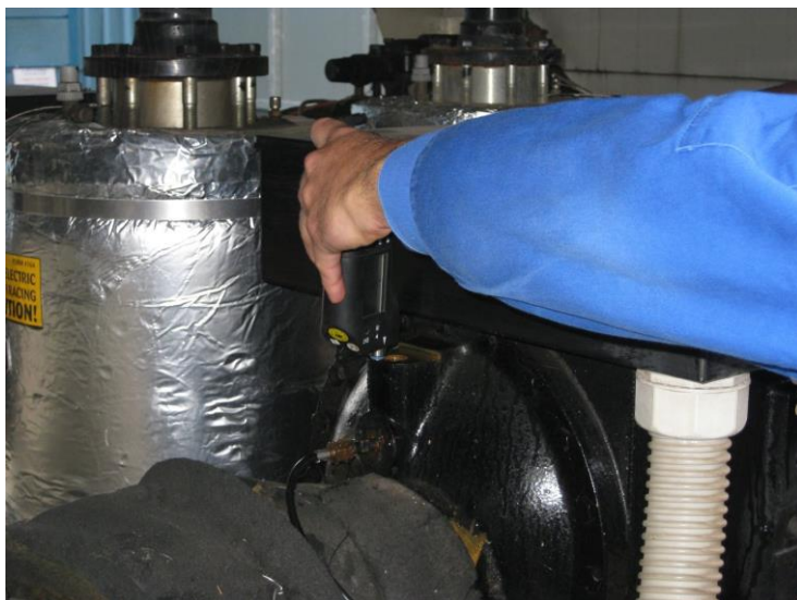
Slika 67: Meritve vibracij na CZ hladilni enoti (Foto: inšpekcija URSJV)
