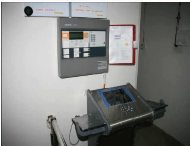
Slika 59: Nova neodvisna požarna centrala je nameščena v predprostoru skladišča
