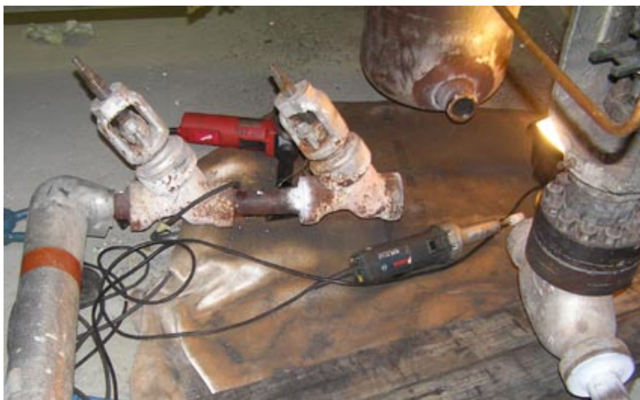
Slika 2.43: Puščanje na drenažni liniji sistema glavne pare
