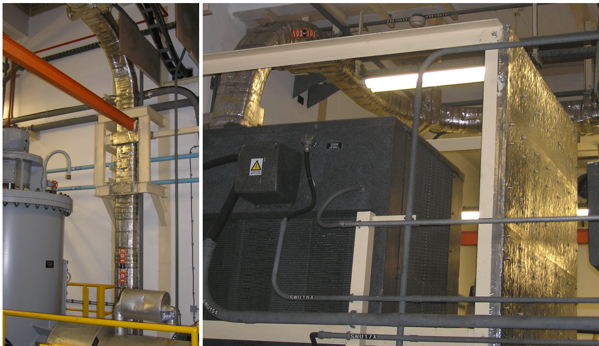
Slika 75: Požarne bariere komponent in kablov NEK (Foto: inšpekcija URSJV)
