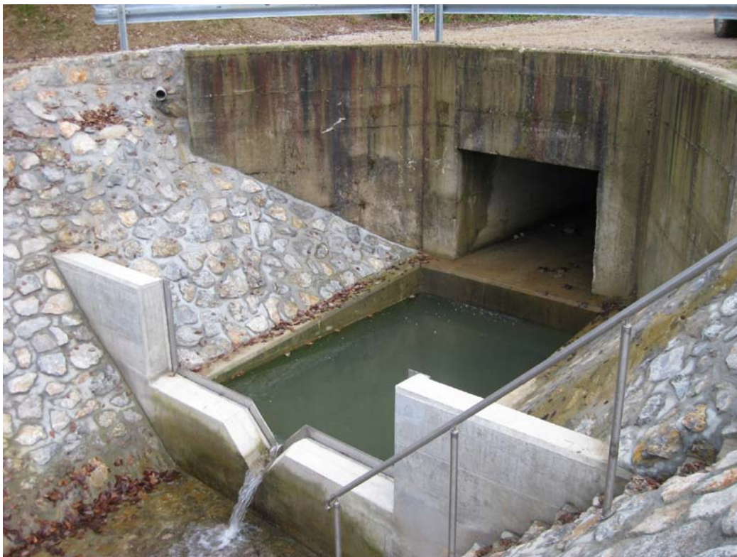
Slika 66: Izcedne vode z vplivnega območja odlagališča Boršt se stekajo v en odvodnik, na katerem je zgrajeno tudi eno merilno mesto, »Boršt potok - glavni« (foto: Inšpekcija URSJV, 2009)
