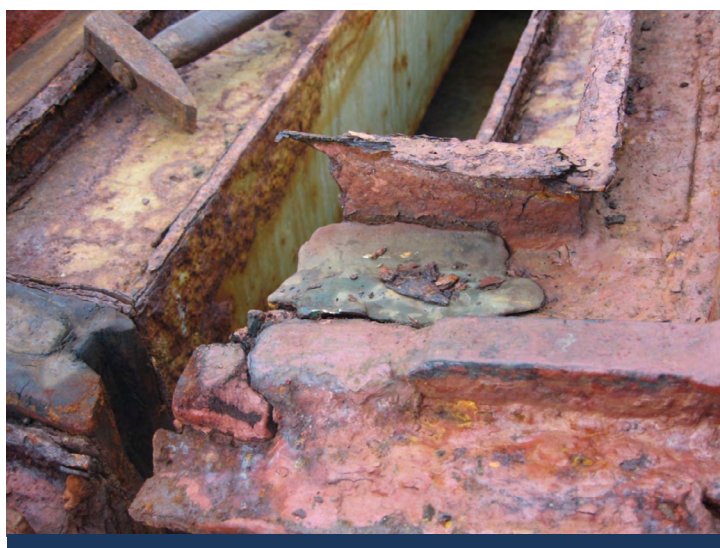
Slika 17: Neustrezno vzdrževani ladijski pokrovi
