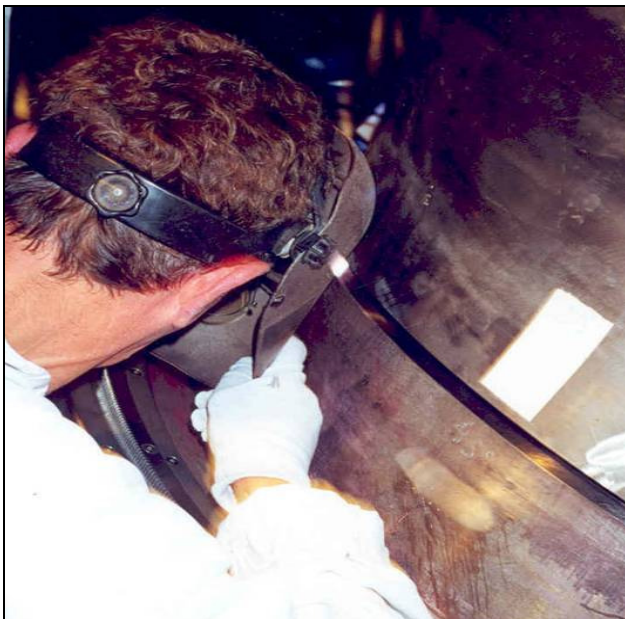
Med remontom v Nuklearni elektrarni Krško (foto: Arhiv URSJV)
