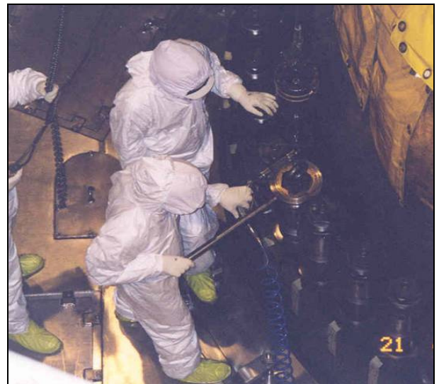
Med remontom v Nuklearni elektrarni Krško (foto: Arhiv URSJV)
