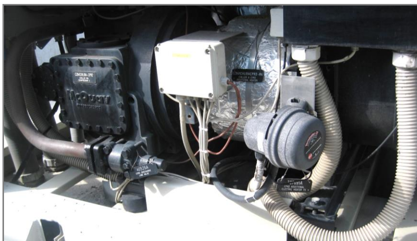
Slika 68: Področje poškodovanih kablov na CZ hladilnih enotah (Foto: inšpekcija URSJV)
