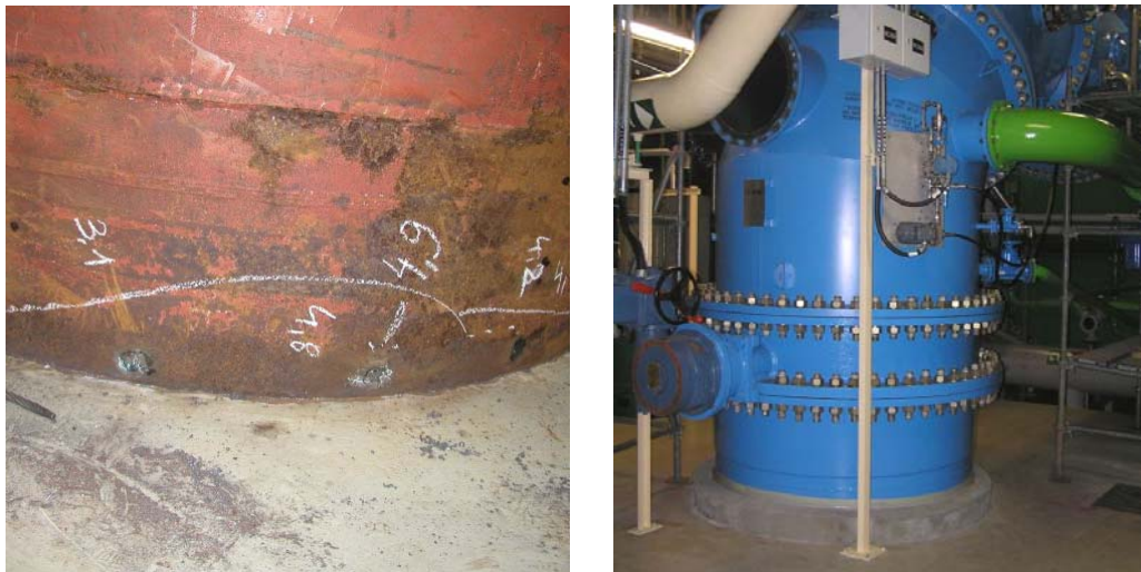
Slika 2.28: Korodiran cevovod vode za hlajenje kondenzatorja (levo) in sanirano stanje (desno).
