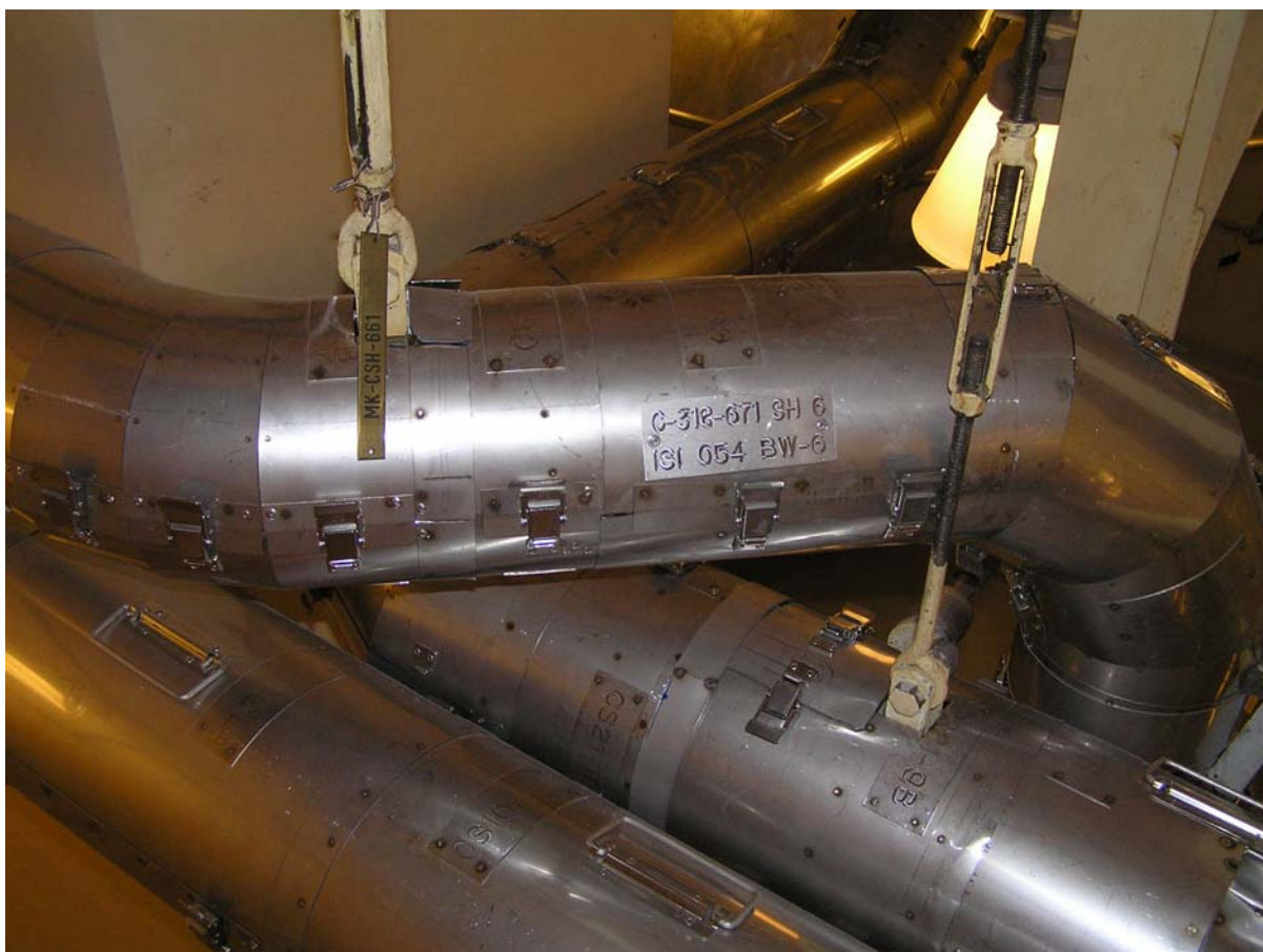
Slika 2.46: Nova izolacija cevovodov v zadrževalnem hramu
