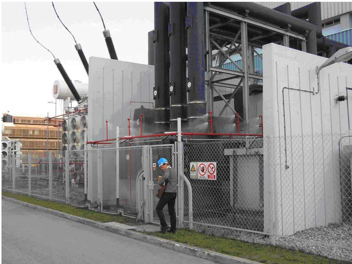
Slika 2.40: Test pršilnih sistemov za gašenje transformatorja lastne rabe NEK
